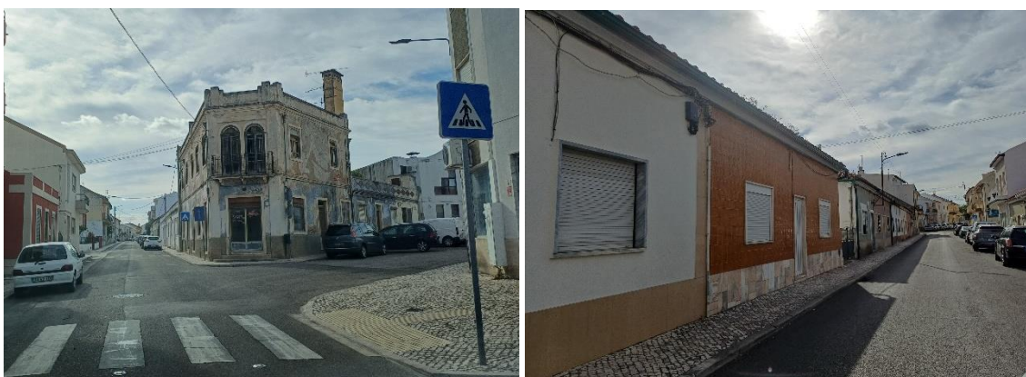
Fotos 03 e 04 – Exemplo de edifícios em mau ou razoável estado de conservação
